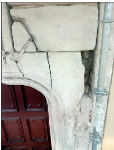
7. Uszkodzenia węgara prawego, fot. M. Jańczuk
