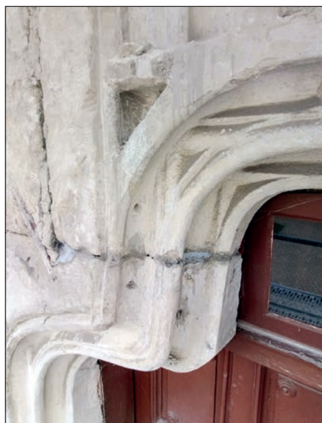
8. Uszkodzenia węgara lewego, fot. M. Jańczuk
