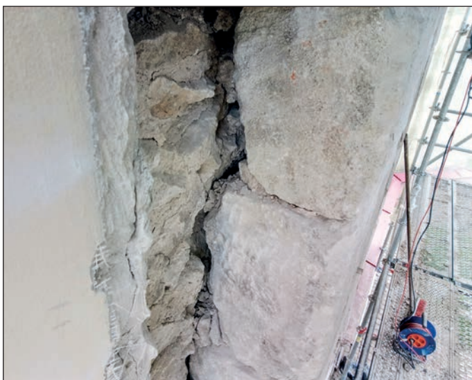
4. Rozszczelnienie łącz kamienia, fot. M. Jańczuk
