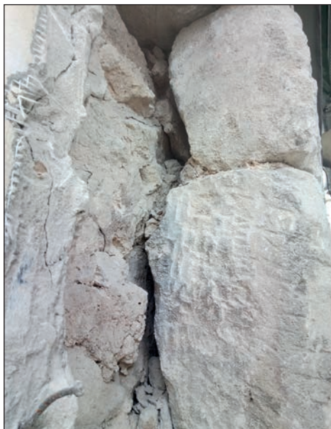
5. Uszkodzone węgry portalu, fot. M. Jańczuk
