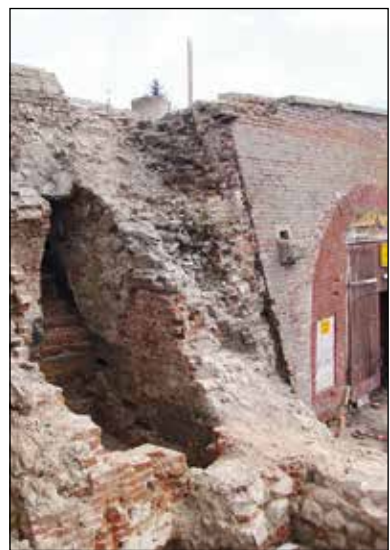
Fot. 10. Przejście z galerii strzelniczej kurtyny I-II do prawego barku Bastionu I. Po prawej stronie w głębi widoczna zewnętrzna ściana prawej kazamaty Bastionu I z wejściem (fot. J. Kuśnierz).
