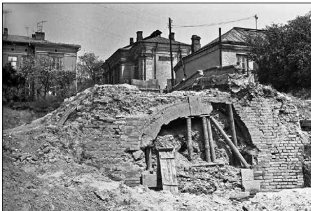
Fot. 8. Zewnętrzne wejście do poterny kurtyny II-III („Furty Wodnej”). Fot. S. Kowalicki 1980.
