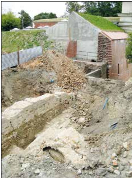
Fot. 36. Styk kurtyny IV-V z prawym bokiem Bramy Lubelskiej Starej. Na pierwszym planie widoczny uszkodzony strop lewej kazamaty bastionu V. (Fot. E. Starczewska 2010).
