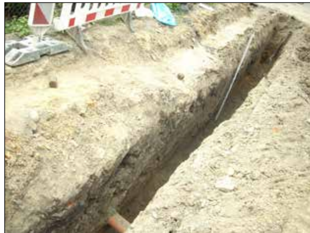
Fot. 16 Włodawa, ul. Przechodnia, przekrój szerokiego zagłębienia w profilu południowym wykopu pod wodociąg, będącego prawdopodobnie zasypiskiem fosy jako elementu umocnień miejskich. Fot. W. Mazurek.
