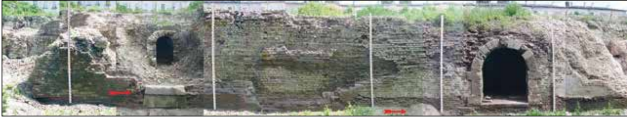
Fot. 29. Odcinek kurtyny III-IV z wejściem do poterny (w trakcie badań 2011). Strzałki wskazują lokalizację kanałów (fot. J. Kuśnierz).
