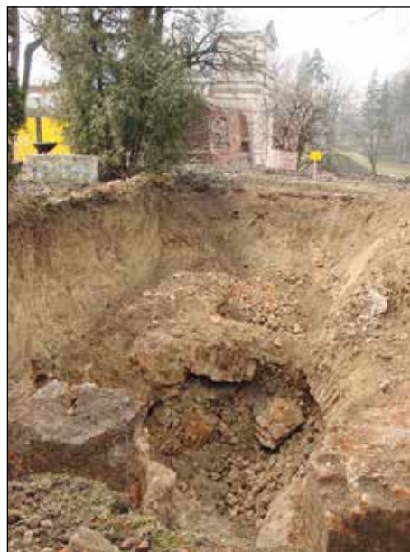
Fot. 33. Zniszczony strop Furty Janowickiej. W tle Brama Lubelska Stara (fot. J. Kuśnierz 2009).
