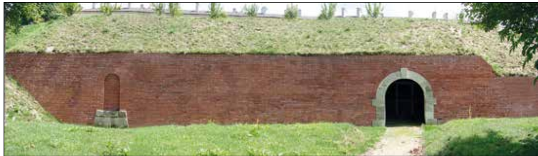
Fot. 30. Odcinek kurtyny III-IV z wejściem do poterny, Stan obecny. (Fot. J. Kuśnierz 2017).
