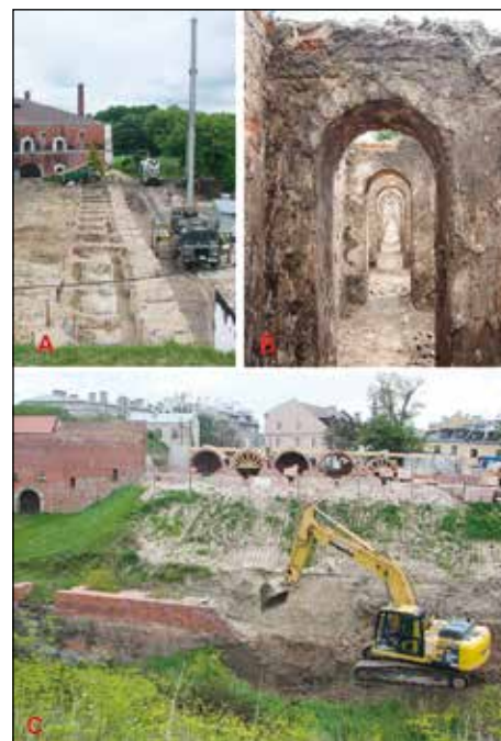
Fot. 48. Odsłonięte pozostałości galerii strzel- niczej w kurtynie VI-VII (A, B) oraz początek prac rekonstrukcyjnych (C). Na lewo od koparki (C) fragment odsłanianego muru Carrnota. (Fot. J. Kuśnierz 2011).
