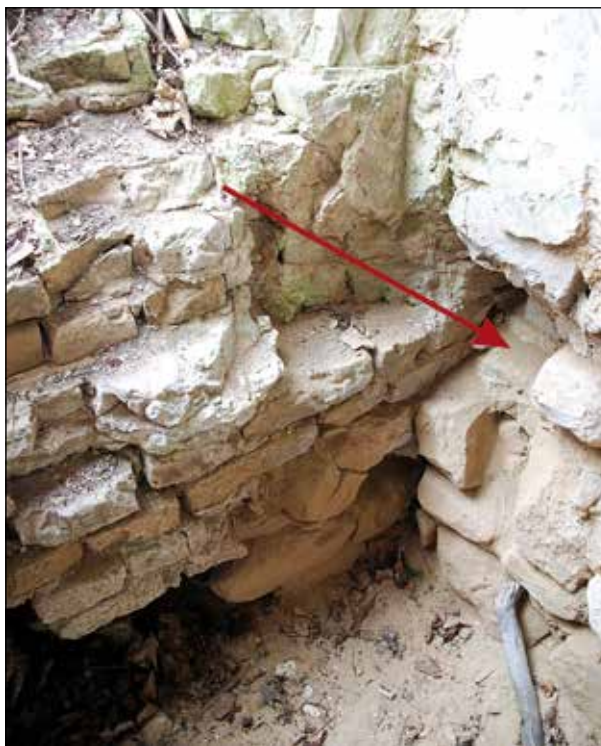
Fot. 10. Pozostałości niewielkiej piwniczki? pod kazamatą z zaznaczonym otworem na legar podłogi z drewna (fot. S. Gołub)
