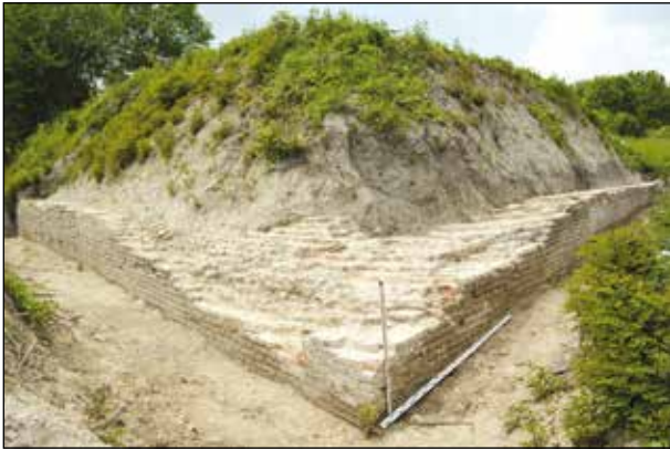
Fot. 5. Kryłów, gm. Mircze. Bastion wschodni. Ujęcie od północnego wschodu. Widoczne węgło bastionu ze śladami uszkodzeń muru ceglanego i częściowej rozbiórki. Nad murem ziemny nasyp oczyszczony do poziomu nawarstwień historycznych (fot. M. Piotrowski)
