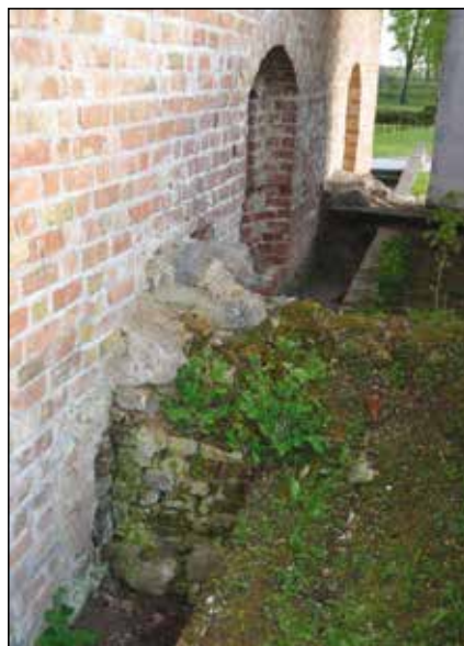
Fot. 5. Zachowane fragmenty fundamentów zamku kodeńskiego, fot. M. Bienia
