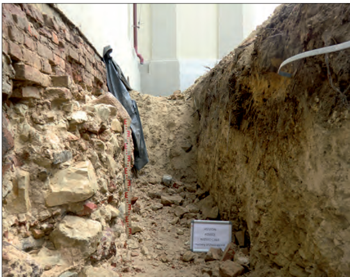
Fot. 3. Południowa partia fundamentowa kościoła i profil ziemny wykopu z widocznym wysokim poziomem geologicznego podłoża w postaci zlasowanej skały wapiennej (fot. M. Matyaszewski).
