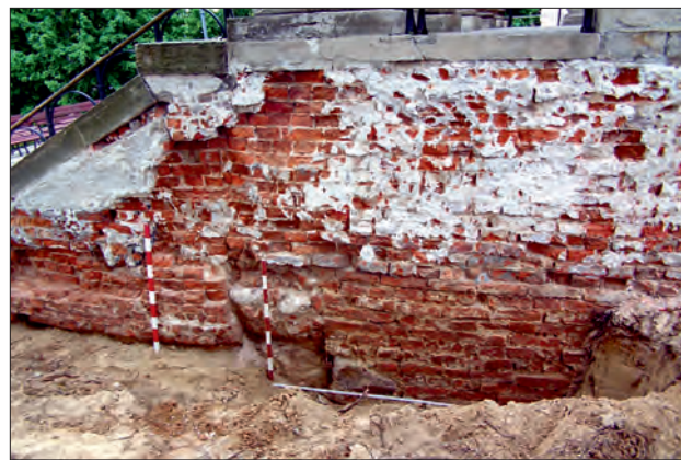
Fot. 7. Rozwarstwienie pomiędzy dobudowaną podwaliną schodów a fundamentem przedsionka (fot. R. Niedźwiadek).
