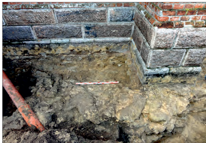
Fot. 2. Mur fundamentowy przypory starszego kościoła pw. św. Wojciecha (faza D), (fot. J. Józwiak).
