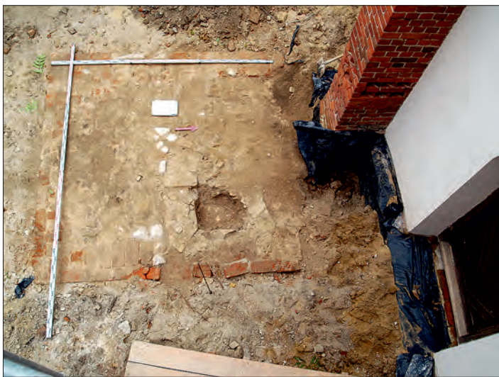
Fot. 11. Fundament filara kolegiaty biskupa Sołtyka z lat 1770-1772 przy południowo-zachodnim narożniku kruchty wejściowej (fot. J. Józwiak).
