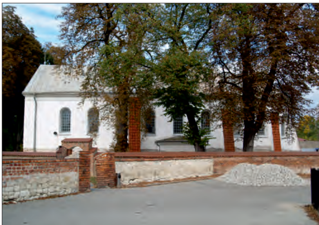
Fot. 1. Kościół w Wilkowie w trakcie prac remontowych, widok od południa (fot. E. Mitrus).
