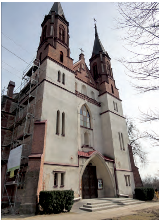
Fot. 1. Część frontowa kościoła w Klementowicach w trakcie trwania nadzoru archeologicznego (fot. D. Włodarczyk).
