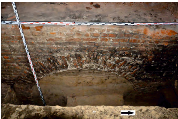
Fot. 2. Lublin, klasztor powiżytkowski, kościół. Wykop 1/10, profil W wykopu z licem muru fundamentowego ściany magistralnej w północnej części nawy, fundowanej na łuku konstrukcyjnym (rys. C. Hadamik).
