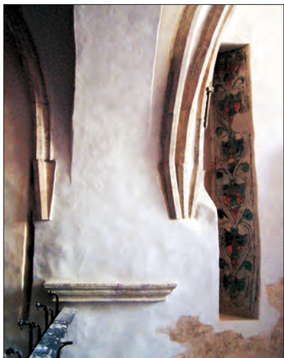
Fot. 6. Zachowane polichromie w gzymsie gotyckiego okna (po prawo), po lewo widoczny jego zarys – stan po konserwacji (fot. R. Niedźwiadek).
