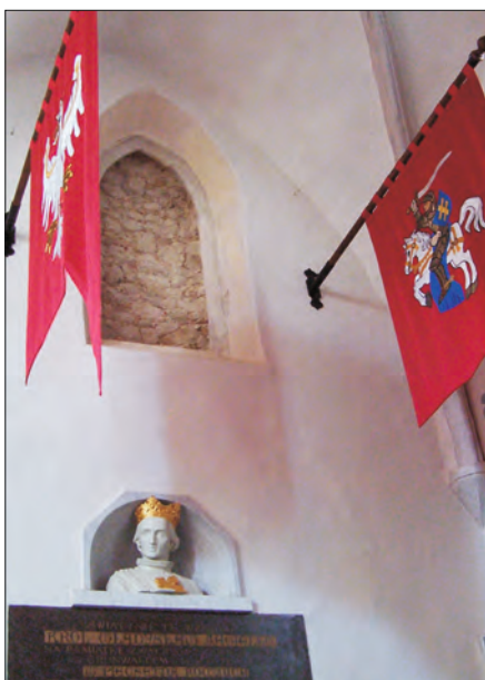
Fot. 12. Widok na gotyckie okno odsłonięte w zach. ścianie kaplicy św. Judy-Tadeusza, stan po konserwacji (fot. R. Niedźwiadek).
