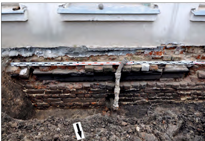
Fot. 5. Lublin, klasztor powizytkowski, kościół, fasada północna. Wykop 6/10, część środkowa. Lico północne muru fundamentowego fasady północnej z zachowanym piaskowcowym progiem kościoła Wizytek. Nad progiem widoczne przemurowania związane z likwidacją otworu wejściowego, widok na S (fot. R. Solski).
