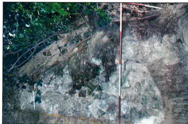
Fot. 1. Wawolnica, woj. lubelskie, stan. 1 – Wzgórze Kościelne. Fundament obwodowego muru obronnego z czasów Kazimierza Wielkiego.
