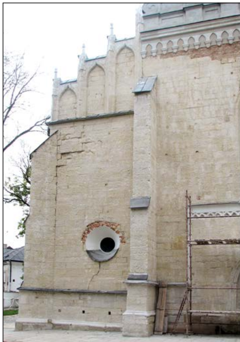
15. Zdj. lewe: Kraśnik, północny fragm. fasady kościoła w trakcie prac konserwatorskich, z oznakami rozluźnienia kamiennych ciosów pod gzymsem i przy narożnej skarpie.
