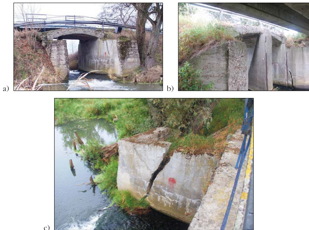
Rys. 13. Ściany przyczółków a) widok mostu od odpływu b) częściowa rozbiórka ściany przyczółka prawego od napływu c) katastrofa budowlana prawej zewnętrznej od odpływu ściany przyczółka.
