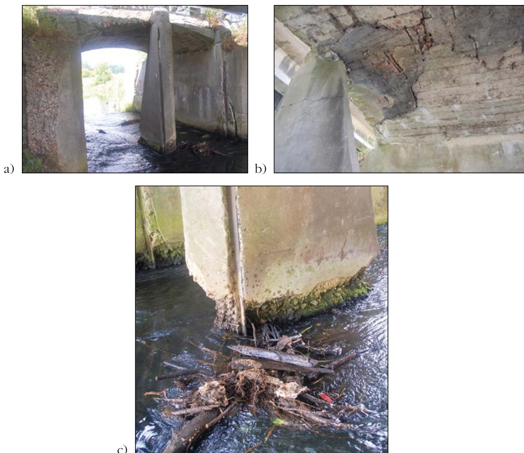
Rys. 12. Urządzenie zastawki pod mostem w Wólce Nowodworskiej: a) filar i światło mostu od napływu b) ślady napraw, połączenie filara z krawędzią łuku c) rozmycie konstrukcji betonowej w wymiarze do 20 % pola przekroju filara
