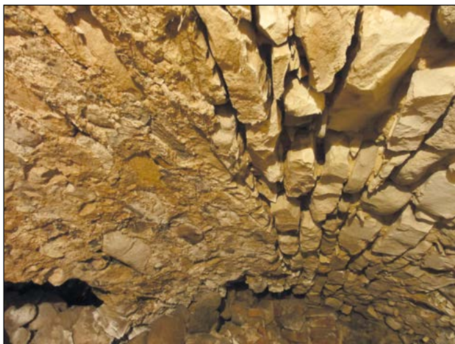
Fot. 9. Zbliżenie na rozwarstwienie widoczne w sklepieniu pomiędzy murem południowym IVa (prawa strona) i północnym murem IVb (lewa strona). Ujęcie od strony zach.
